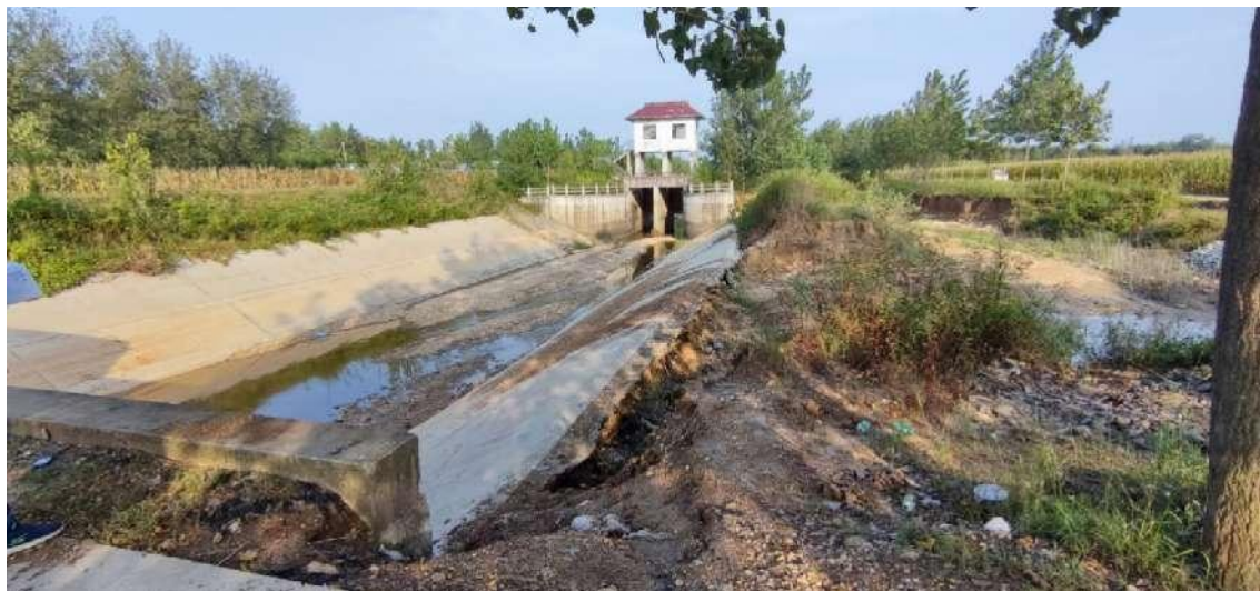
图 3.2-36 马岭防倒灌闸右岸防护结构被冲毁
