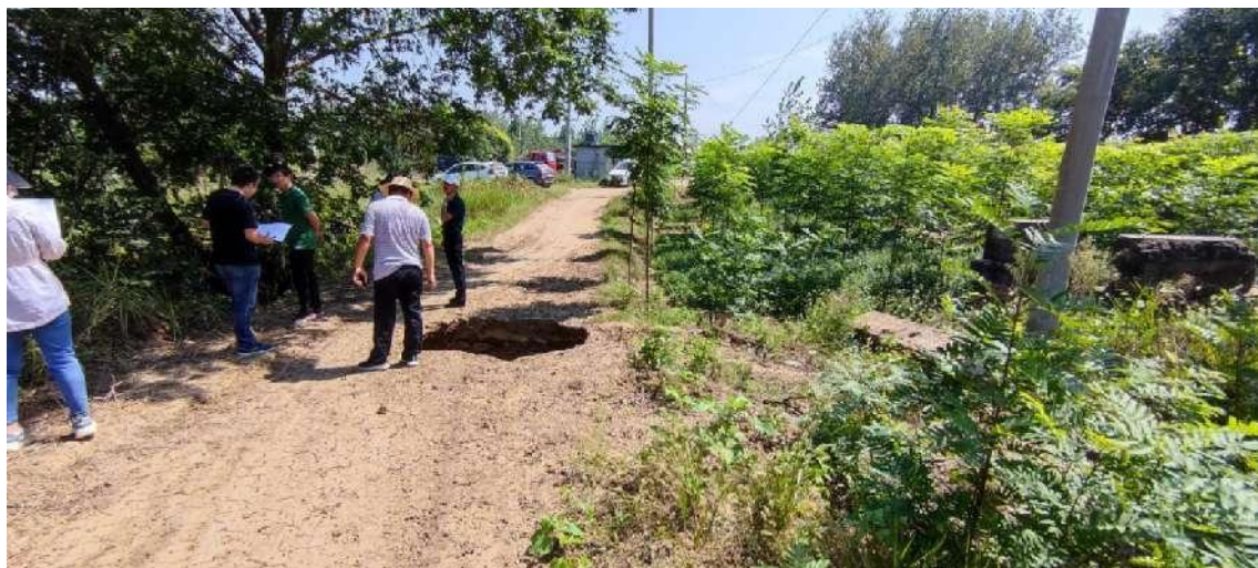
图 3.2-38 周圩中沟闸穿堤涵洞损毁，路面出现塌坑
