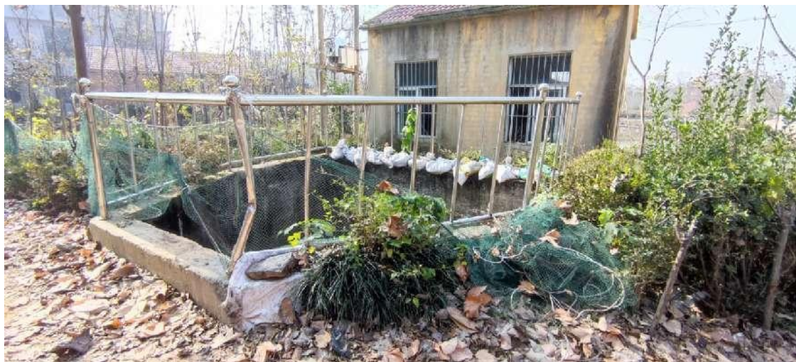
图 3.2-26 徐口站出水池侧现状（池顶高程不足）
