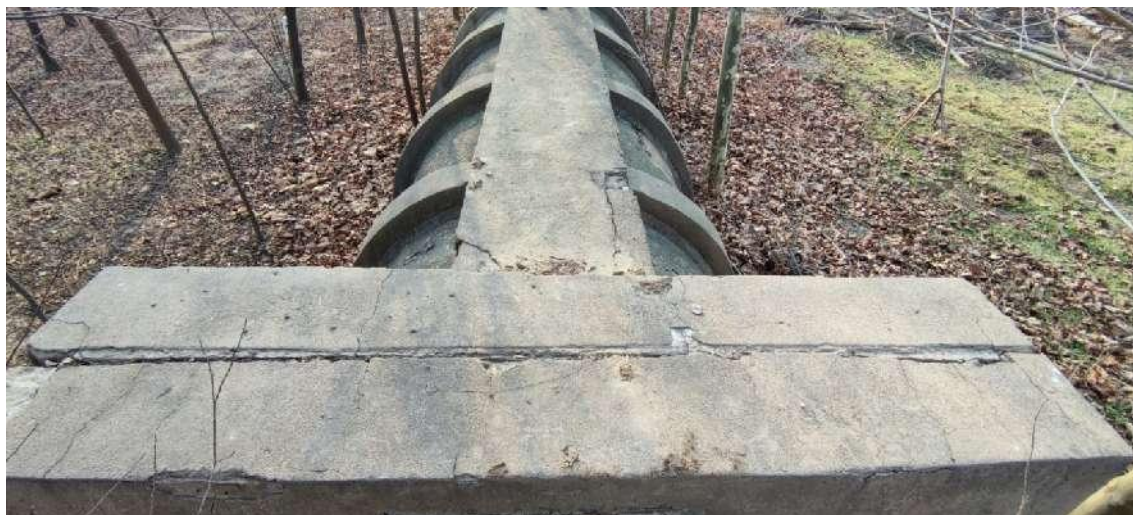
图 3.2-15 项宅站破损的出水涵洞
