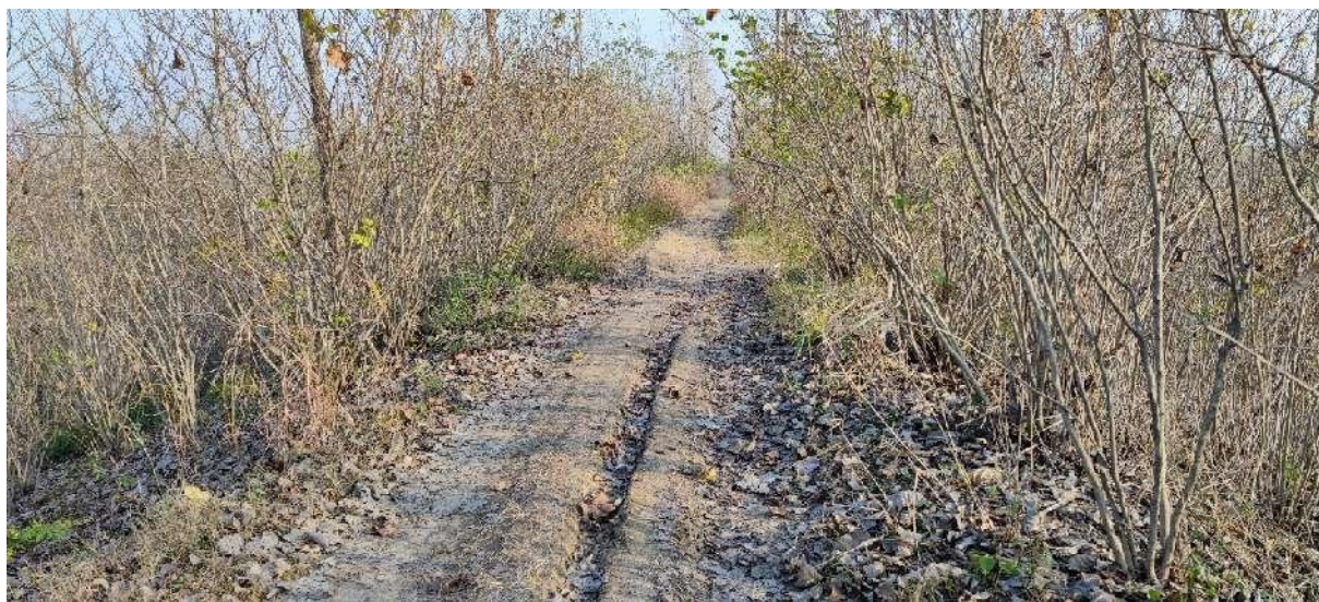
图 3.2-50 现状树木茂密、车辆无法通行段堤顶道路
